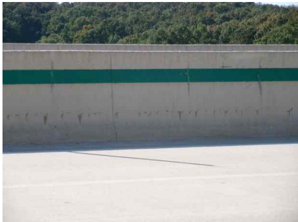
S2 중분대 균열( C_w=0.3\text{mm} 미만)
