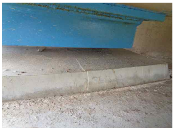
A1-Sh7 받침물탈 균열( Cw=0.3\text{mm} 미만)
