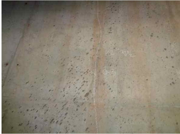
A1 흉벽 균열( Cw=0.3\text{mm} 이상)
