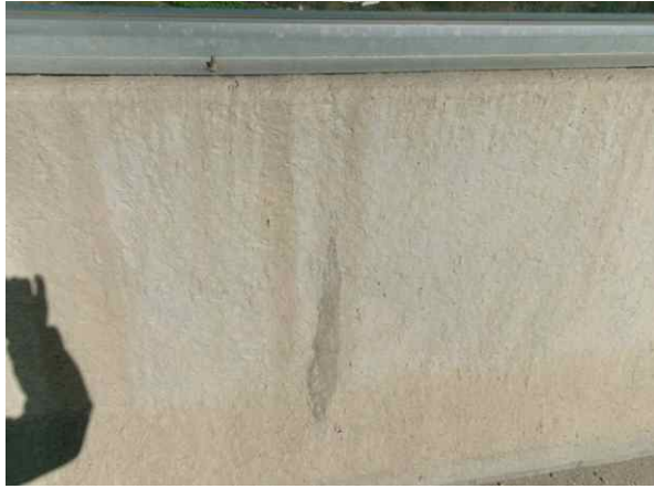
S1 방호벽 균열( C_w=0.3\text{mm} 미만)
